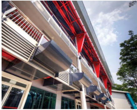
Gambar 11 Outlet cerobong udara
