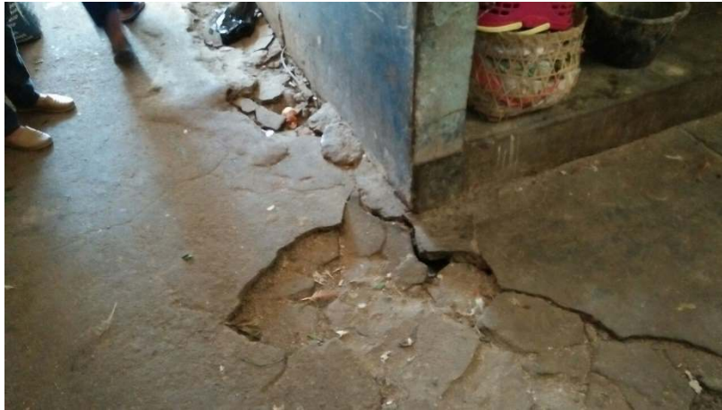
Gambar 9 Kondisi jalan yang rusak
