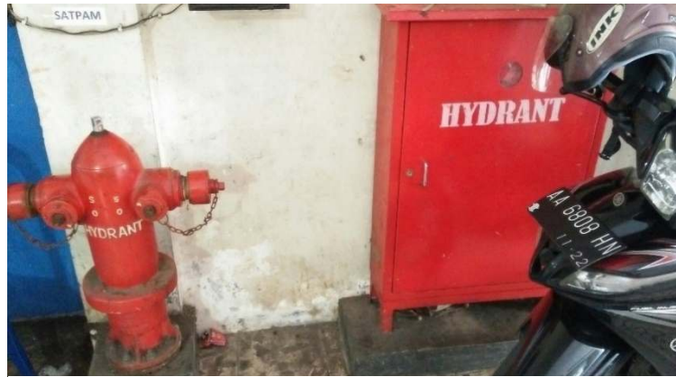
Gambar 1 Hydrant Box dan Siamese
