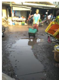
Gambar 4.7 Kondisi jalan Sumber: (Dokumentasi penulis)
