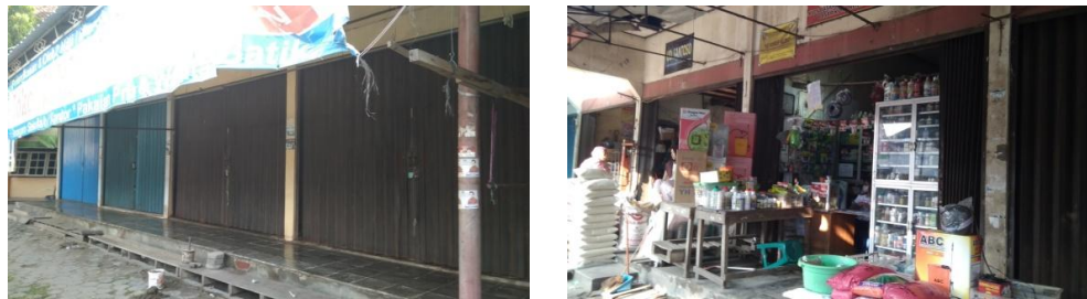
Gambar 4.13 Kondisi Kios Pasar Kota Rembang Sumber: (Dokumentasi penulis)
