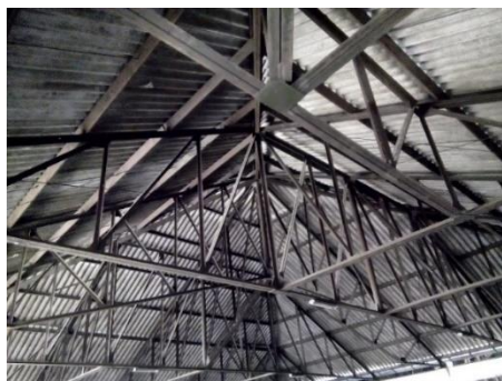
Gambar 3.10 Struktur Atap pada Bangunan Utama Pasar Klaten III Lantai (Sumber : Dokumentasi Pribadi, Maret 2019)
