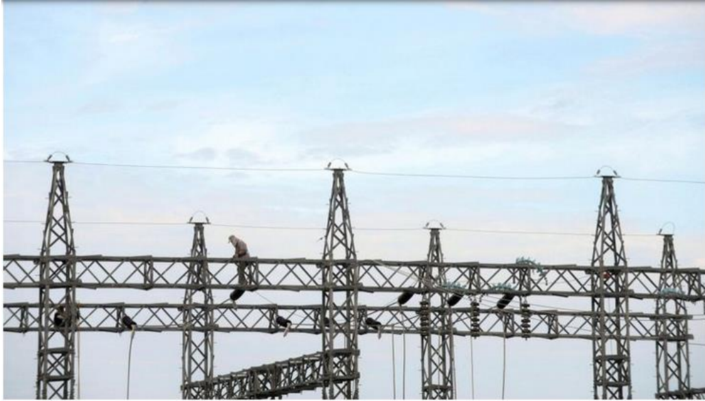
Pembangunan Pembangkit Listrik - Pekerja menyelesaikan pembangunan pembangkit dan jaringan listrik di Kecamatan Taliwang, Kabupaten Sumbawa Barat, Nusa Tenggara Barat, Selasa (12/4/2016). Pembangunan Pembangkit Listrik Tenaga Uap (PLTU) berkapasitas 2x7 megawatt tersebut untuk memenuhi kebutuhan listrik di kawasan Sumbawa. (KOMPAS/P RADITYA MAHENDRA YASA)
