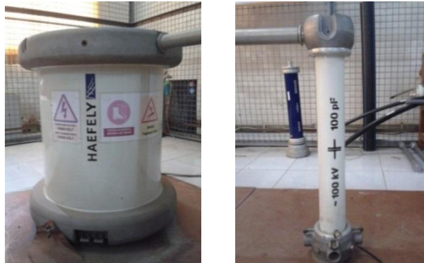
(a) Trafo tegangan tinggi (b) Kapasitor pengukuran
