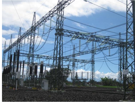
Gambar 2.3 Gardu Induk berisolasi Udara (Sumber : GI Temanggung pada tanggal 12 Maret 2018)
