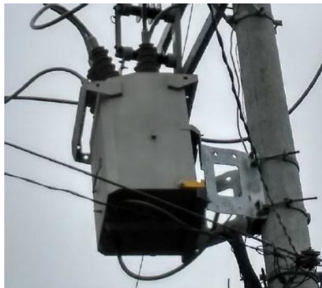
Gambar 2.9 Penutup Balik Otomatis ( Recloser )
