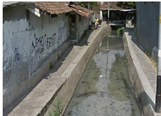
Gambar 6.5 Saluran drainase pada tapak
