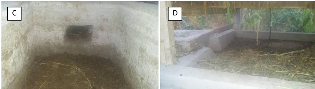
Ilustrasi 3. Kandang kambing yang terintegrasi dengan instalasi biogas, (A, B). Bak penampungan dan bak perendaman, (C) Lubang penghubung antara lantai kandang dan bak penampungan (D). Lantai bawah kandang kambing
