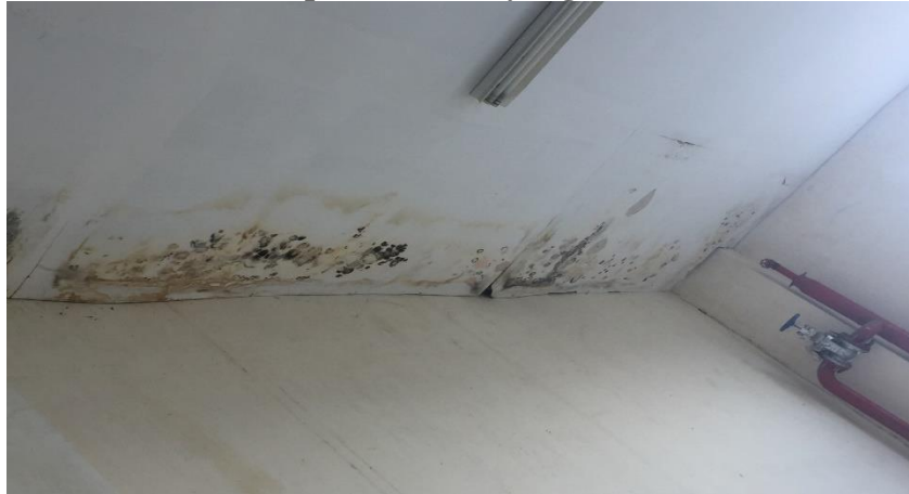
Gambar 3.8 Atap Pasar Bulu yang Bocor
