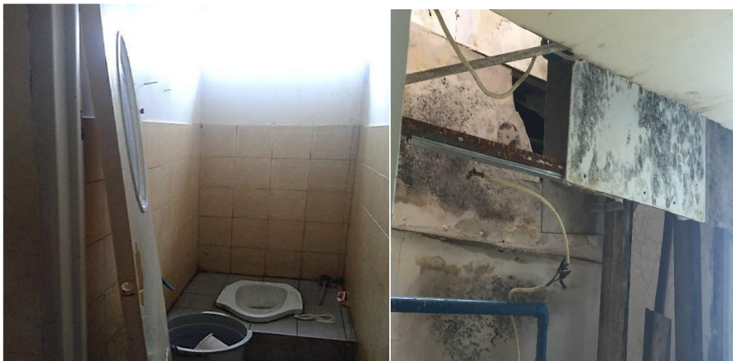
Gambar 3.6 Kerusakan Pada Toilet Pasar Bulu
