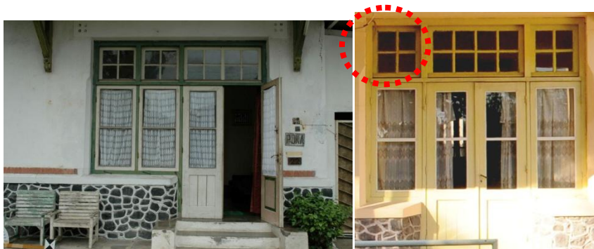
Gambar 4.23 : Macam bentuk Pintu dan jendela utama rumah di Perumahan Woningpark Gergadji. sumber : dokumentasi peneliti, 2012.
