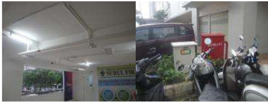
Gambar : jaringan listrik
