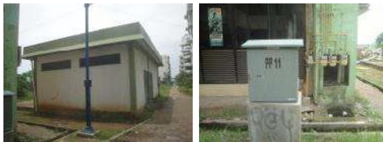
Gambar 2.26 jaringan listrik rusun marunda
