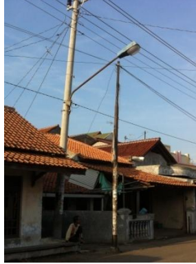
Gambar3.7 Jaringan Listrik di Muarareja
