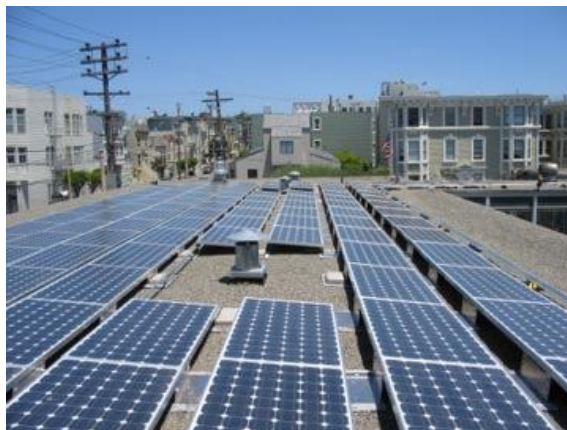
Gambar 2. 1 Panel Surya yang Diletakkan di Atas Atap Bangunan
