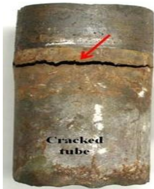
Gambar 2.28 Korosi retak pada pipa [4]
