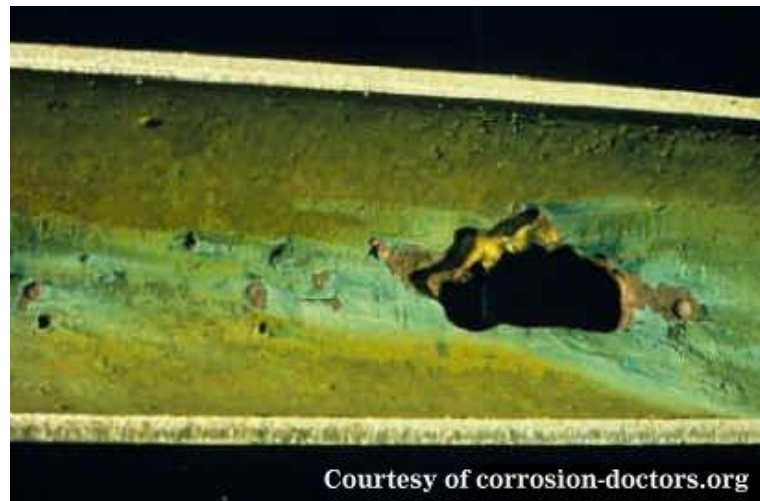
Gambar 2.26 Korosi erosi pada pipa air laut [15]
