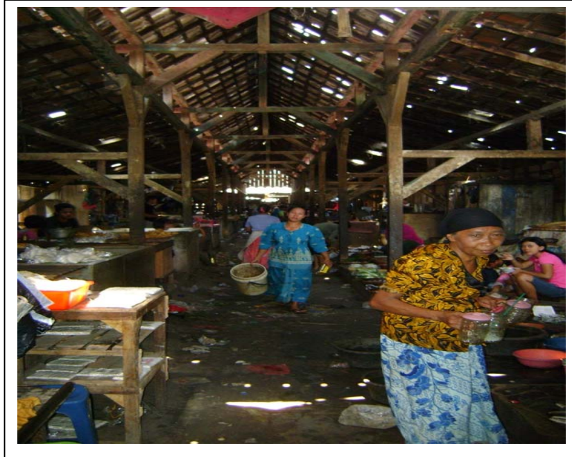
Gambar 4. 8 Kondisi Fisik Bangunan Los Pasar Umum Gubug sebagian besar sudah rusak (Februari 2009)
