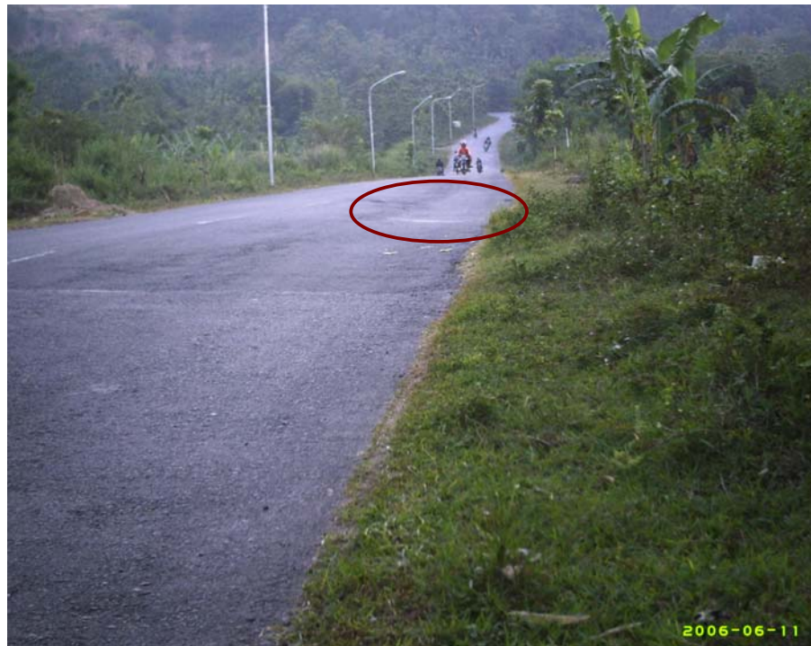
Gambar 1. 1. Ruas jalan Sigar Bencah yang ambles
