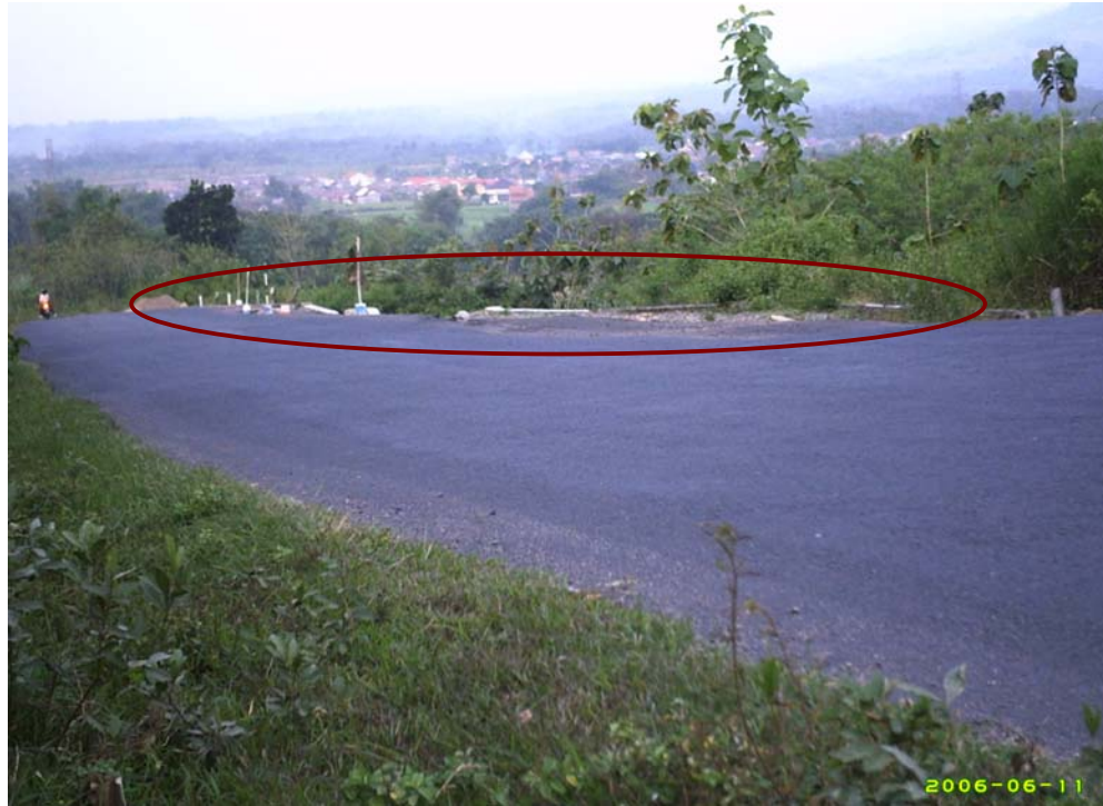
Gambar 1. 2. Ruas jalan Sigar Bencah yang ambles dan longsor
