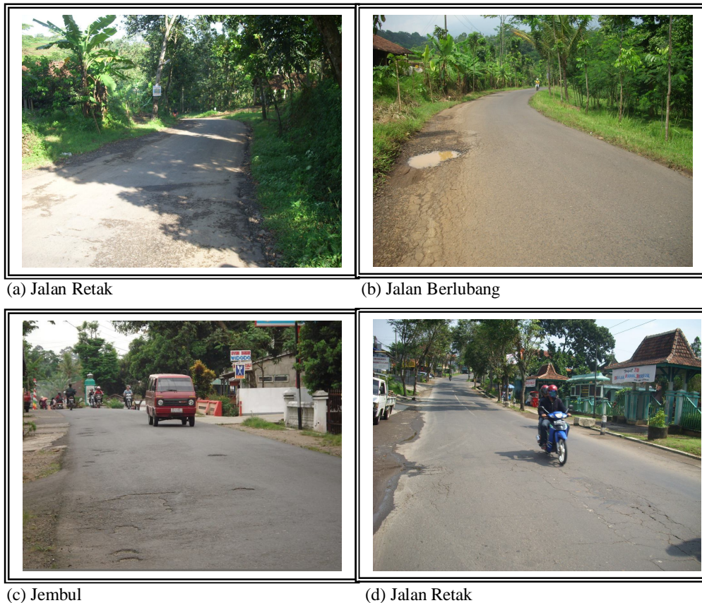
Gambar 1.2 Kerusakan fisik jalan ruas Ungaran - Cangkiran
