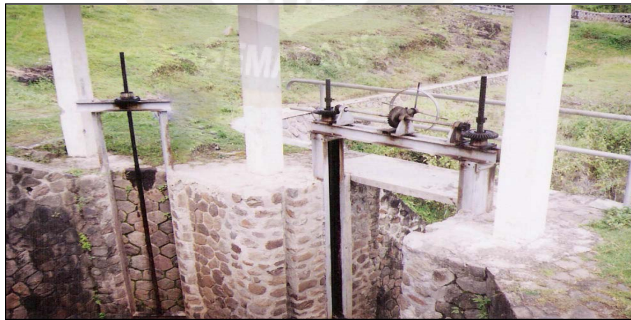
Gambar 3.4 Bentuk Pintu Saluran Pengambilan
