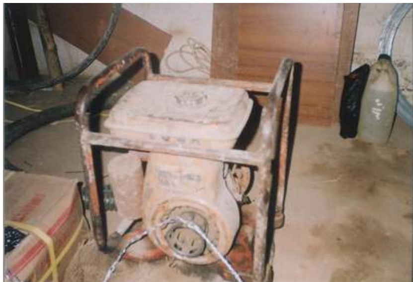
Gambar G. Mesin Genset
