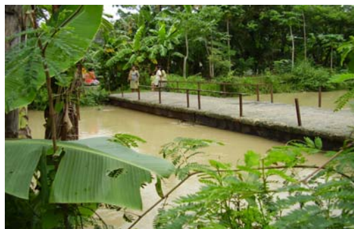
Gambar 4.3 Tinggi jagaan yang tak terpenuhi
