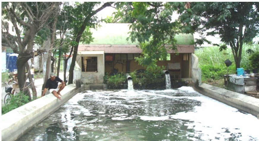
Gambar 4.23 Rumah pompa di Kawasan Tanah Mas yang beroperasi setiap hari dan membutuhkan biaya pemeliharaan yang cukup besar
