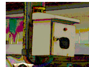
Gambar 4.2 Box Panel pada penerangan jalan
