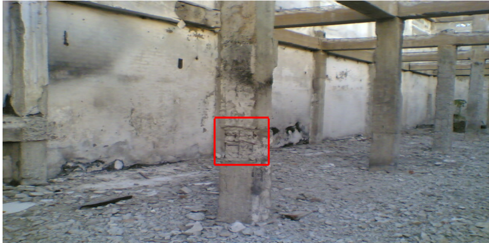
Gambar 7. Tulangan yang ter- exposed pada kolom
