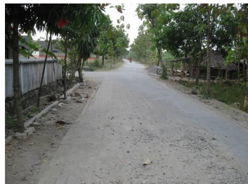
Prasarana jalan yang kurang baik
