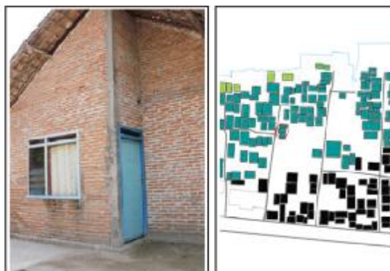
dinding tembok tanpa plester pada lahan HGB di daerah sempadan pantai
