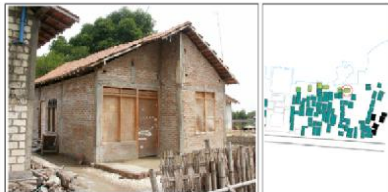
rangka beton tidak rigid pada rumah status ilegal hasil reklamasi
