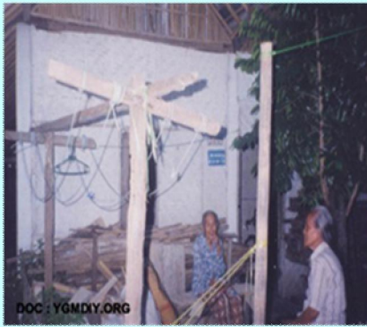
Sebelum diperbaiki, dengan dinding gedeg
