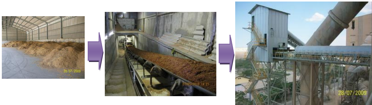
Gambar 6 : Fasilitas Transport Sekam Pabrik Tuban
