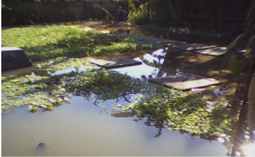
Gambar 4.4 : Septiktank Komunal dengan Kondisi Tergenang Air Waduk Batujai, Kota Praya Kabupaten Lombok Tengah
