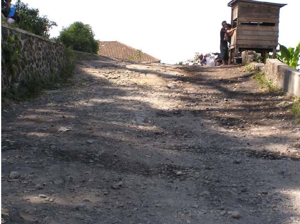
Gambar 5.29 Jalan desa yang rusak
