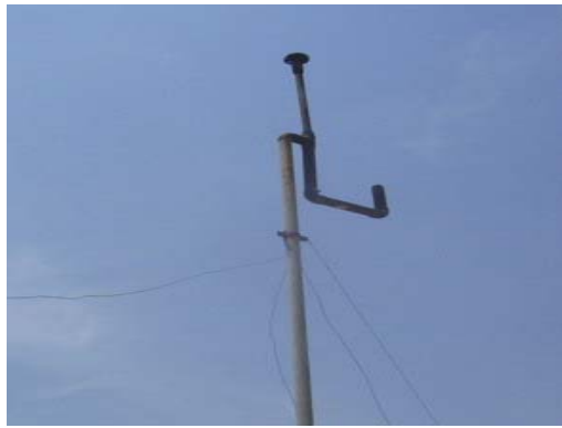
Gambar 21. Pipa Gas Flare
