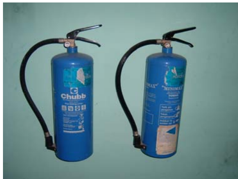
Gambar 2.11 Alat Pemadam Kebakaran
