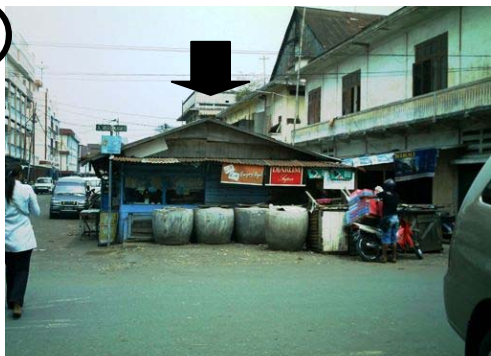
Foto 2.22 kondisi bagian atas parit yang ditutup oleh PKL Sumber: Pengamatan lapangan, november 2006
