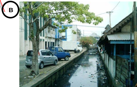
Foto 2.10 Lebar parit yang mengalami penyempitan Sumber: Pengamatan lapangan, november 2006
