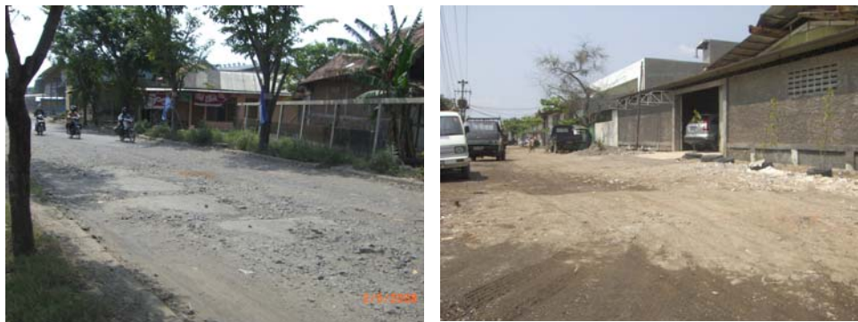
Gambar 5.4 Kondisi tanah yang labil menyebabkan jalan menjadi rusak dan berlubang
