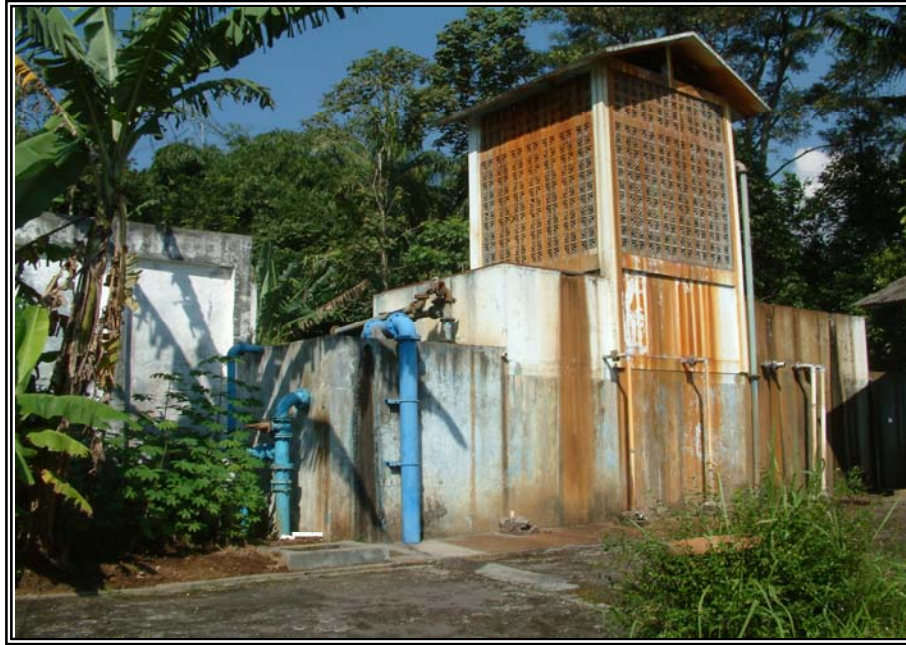
GAMBAR 3.3 BAK PENAMPUNG AIR BERSIH DI WUJIL
