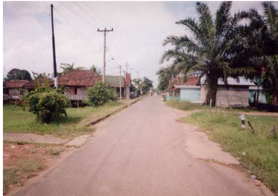
(Gambar 10, Kondisi Jalan Aspal)
