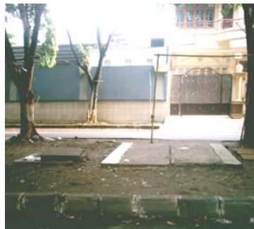
Foto 9. Saluran air yang ditutupi oleh beton pada boulevard
