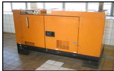
Genset kapasitas 17 KVA.
