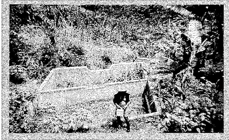
Gambar 4.7. Bak Penampung / Pengolah Lechate ( kemarau )
